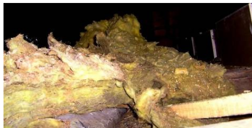
Schimmelbefallene Mineralwollmatten in einem Dachgeschoß (aus Beratungsprojekt)
